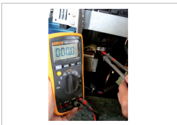
Abb. 42: Messung des Transformators
